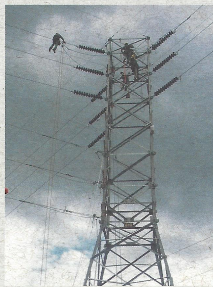
A torre de derivação, de 32 metros de altura, com montadores realizando as ligações
