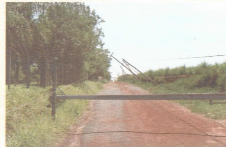
Postes derrubados pelos fortes ventos
