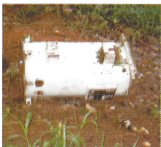
Carcaça de um transformador encontrado sem seu núcleo de cobre
