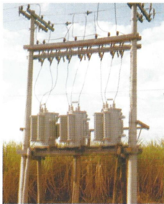
Três reguladores de tensão. Ao centro o que teve o óleo isolante drenado
